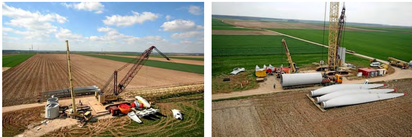
Photographie 8. Aires de levage (Source : Enertrag)
