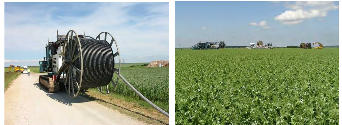
Photographie 11. Raccordement au réseau électrique (source : Enertrag)
